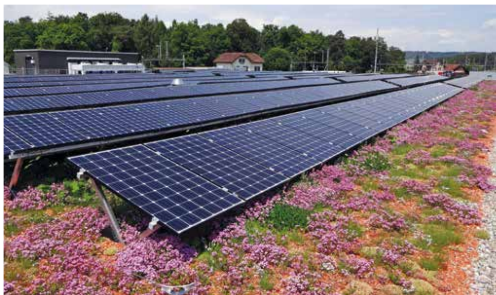
Die Kombination aus Solar und Gründach trifft nicht nur die Anforderungen unserer Zeit. Es birgt auch technisch mehrere Vorteile. Das Flachdach wird damit zum wertvollen Nutzdach. (Foto: Bauder)
